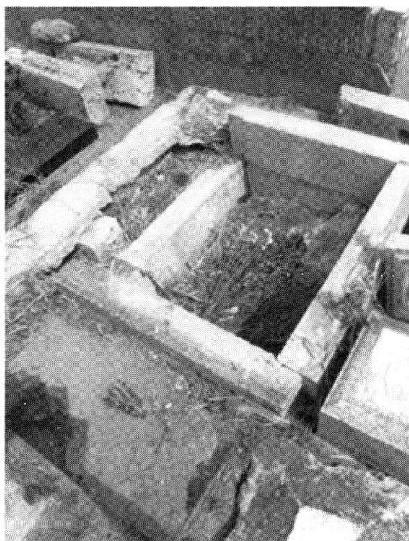
〈写真4〉 洗い流されたカロート内部
