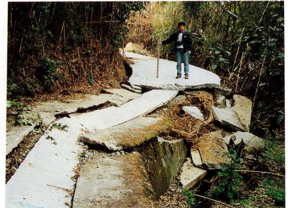
写真26. 地点㉓. コンクリート道の破壊状況
