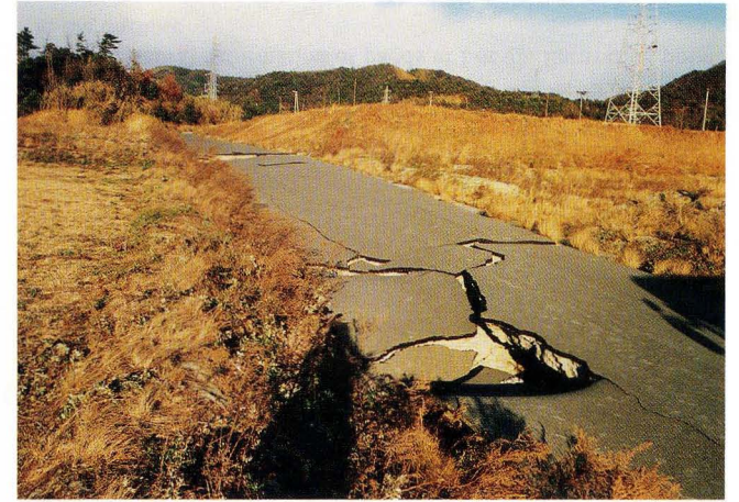
写真50. 地点⑦⑤. アスファルト道の破壊状況 Photo. 50 Destruction of paved road at Loc ⑦⑤
