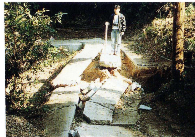
写真28. 地点④. コンクリート道の破壊状況 Photo. 28 Destruction of concrete road at Loc ④
