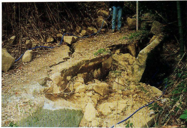
写真38. 地点⑤8. コンクリ ート側壁の崩壊 Photo. 38 Destruction of concrete road and wall at Loc ⑤8
