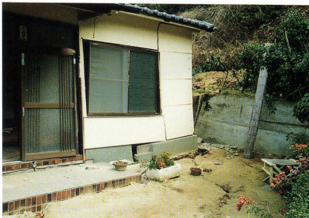
写真35. 地点③. 断層が通過したモルタル家屋
