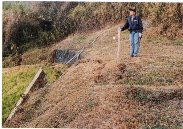
写真4. 地点⑦. 草地の亀裂とコンクリート壁の破壊 Photo. 4 Extensional cracks and destruction of concrete wall at Loc ⑦
