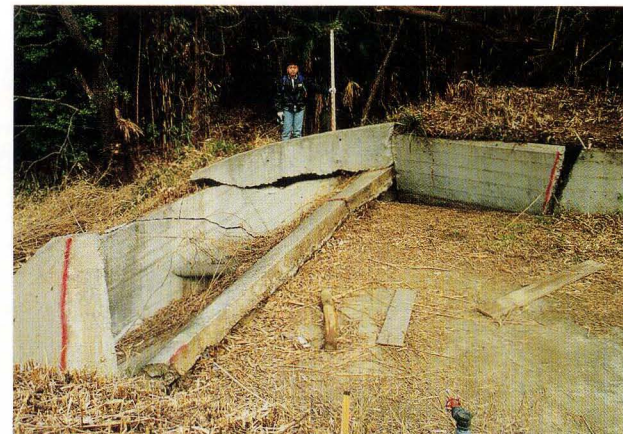
写真36. 地点⑤. 越水流口の破壊状況
