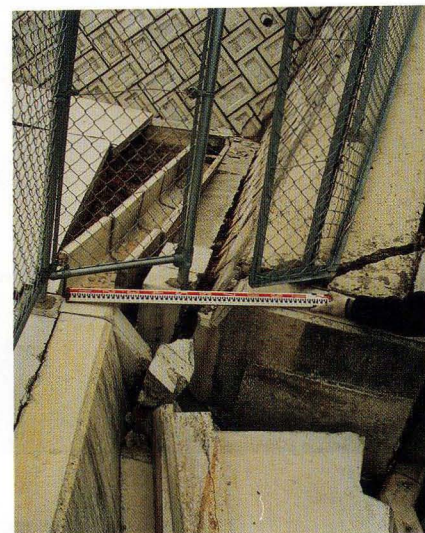
写真31. 地点④⑤. 右ずれによる金網フェンスの変位
