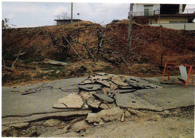
写真52. 地点⑦. アスファルト道路の膨らみ変形
