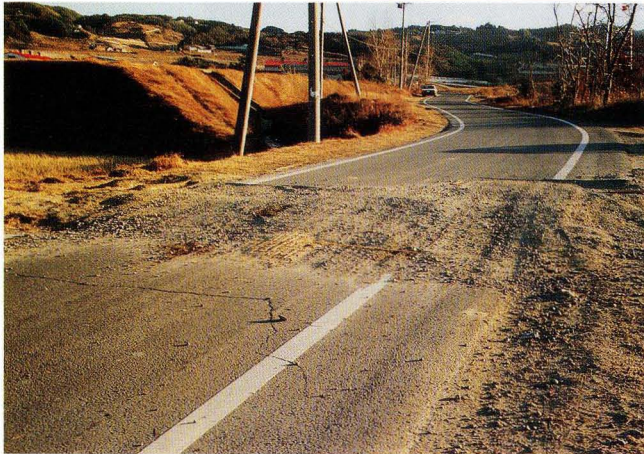
◀ 写真49. 地点⑦④. 県道のア スファルト破壊と右ず れ
