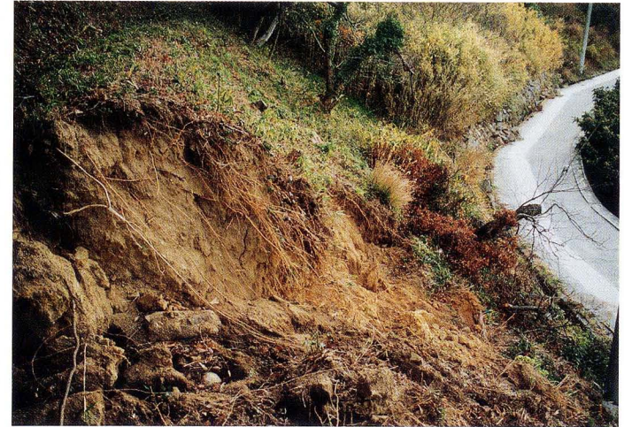
写真19. 地点㉗. 溜池堤の石積の破壊
