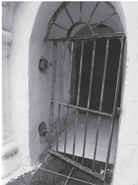
Fig. 12 Broken grille door
